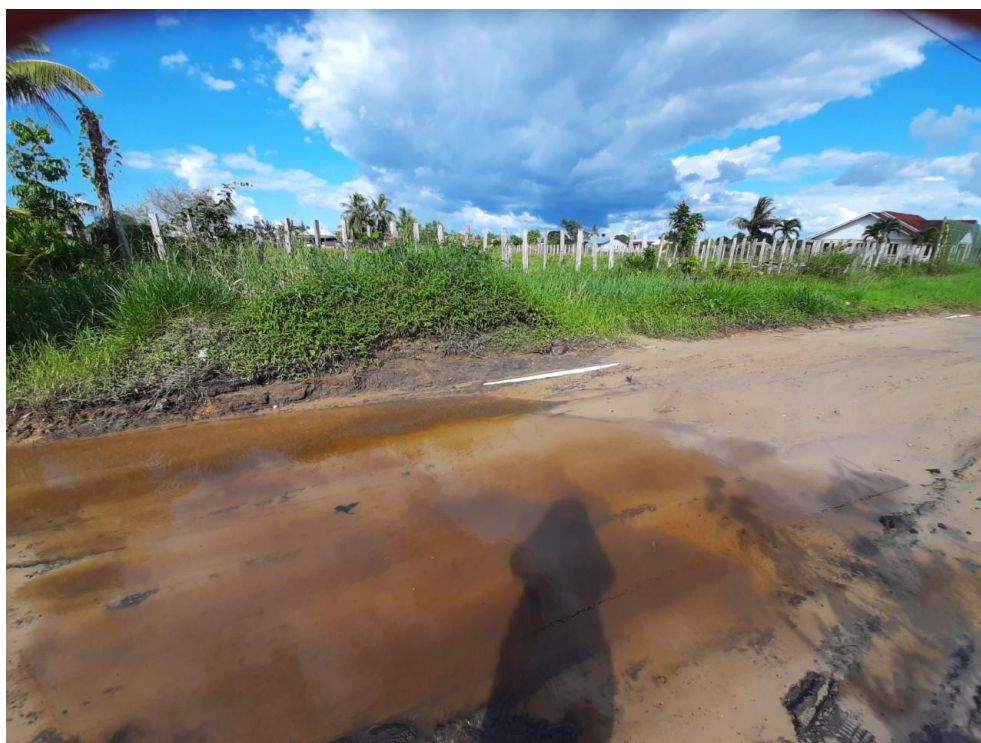
Foto 14: Door het weggespoelde zand is de SWM buis van de straat al zichtbaar
